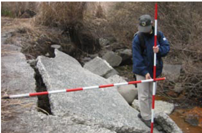
崩壊した管理道の調査
