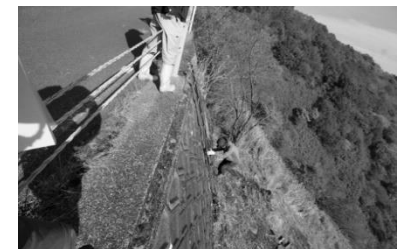
安全な動線確保が課題となっている箇所
