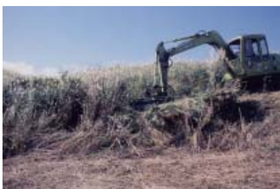
道にあるコンボ本体からアームを伸ばし草刈りアタッチメントで法面の草を刈る
